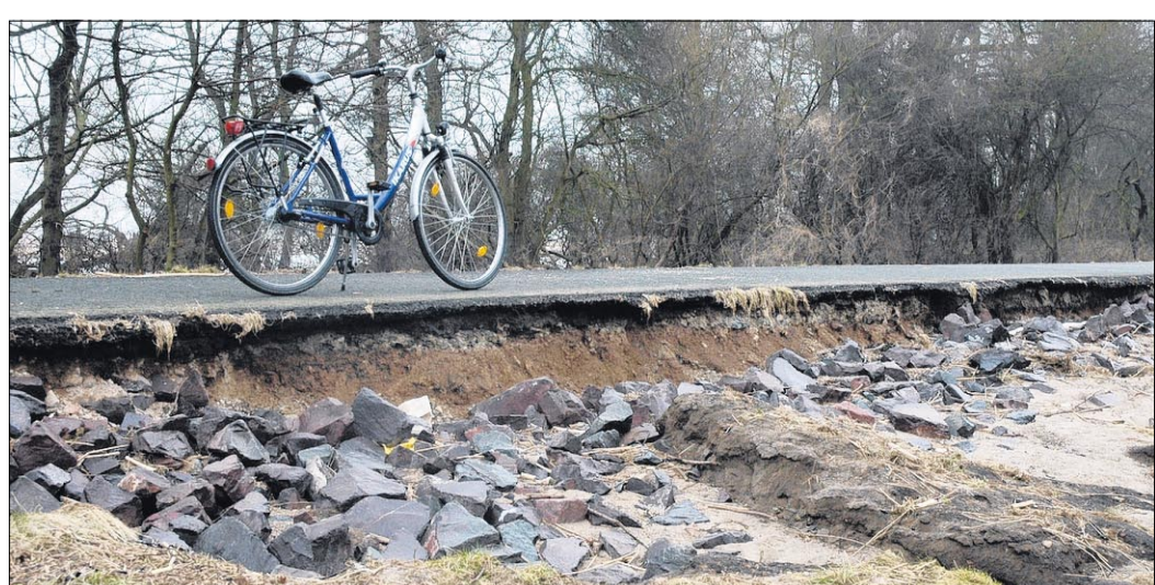
Schaden am Onkel-Toms-Hütte-Deich. Niemand weiß, wann er repariert werden kann. Foto: Hoffmeister
